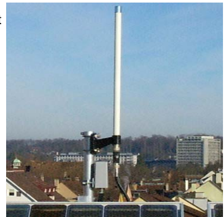
Antenne auf dem Dach E-Gebäude ZHAW
